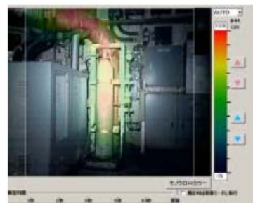
図3 γカメラによる1号機南側調査結果 (AC系配管のホットスポット)
