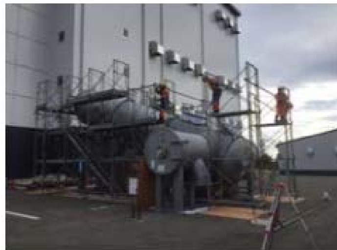
ベント管1/1スケール試験
